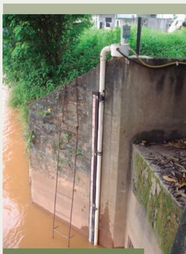
Instalação do sensor de nível da estação automática de Ponte Nova – Bacia do rio Doce (ES).
