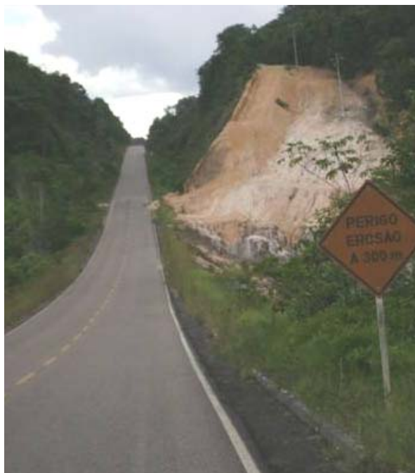
Processo de voçorocamento induzido em corte da rodovia BR-174 (Manaus, AM).
