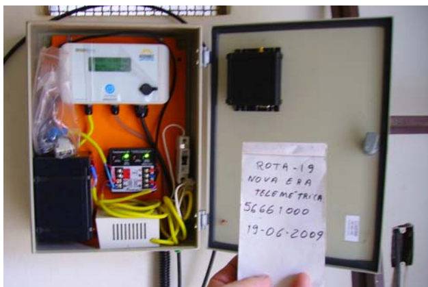
Estação telemétrica automática em Nova Era (MG).
