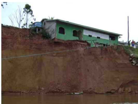
Construção em situação de risco devido a desmoronamento do talude do rio Solimões, na orla da cidade de Jutai (AM).
