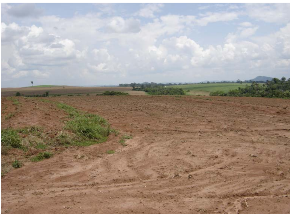
Trecho da rodovia RO-485, transformada em extenso areão (RO).
